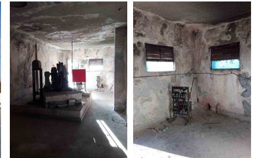
Foto 2 y 3 - SUPERFICIE DE CIELORRASO Y REVOQUE DE PAREDES TOTALMENTE AFECTADA POR LA HUMEDAD
