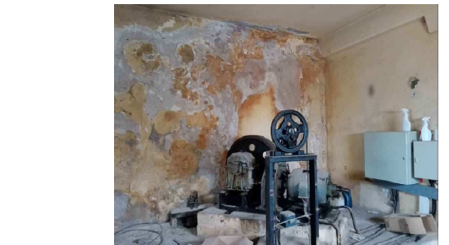
Foto 3 , 4 Y 5 REVOQUE INT. SALA DE MÁQUINAS
