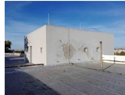
Foto 1 - REVOQUE EXTERIOR SUELTO
