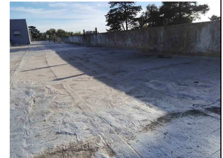
Foto 5 - AGLOBAMIENTO DE MEMBRANA ASFÁLTICA
