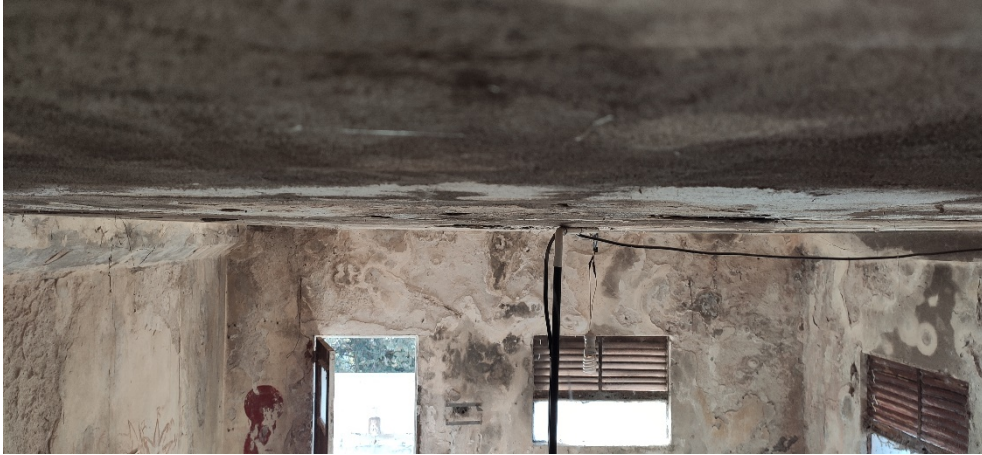
Figura 4. Losa de la sala de máquinas central flechada
