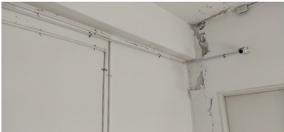
Figura 2. Fisuras perimetrales en muro de junta de dilatación
