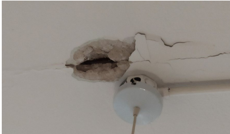
Figura 3. Armadura de tracción expuesta en pasillos centrales
