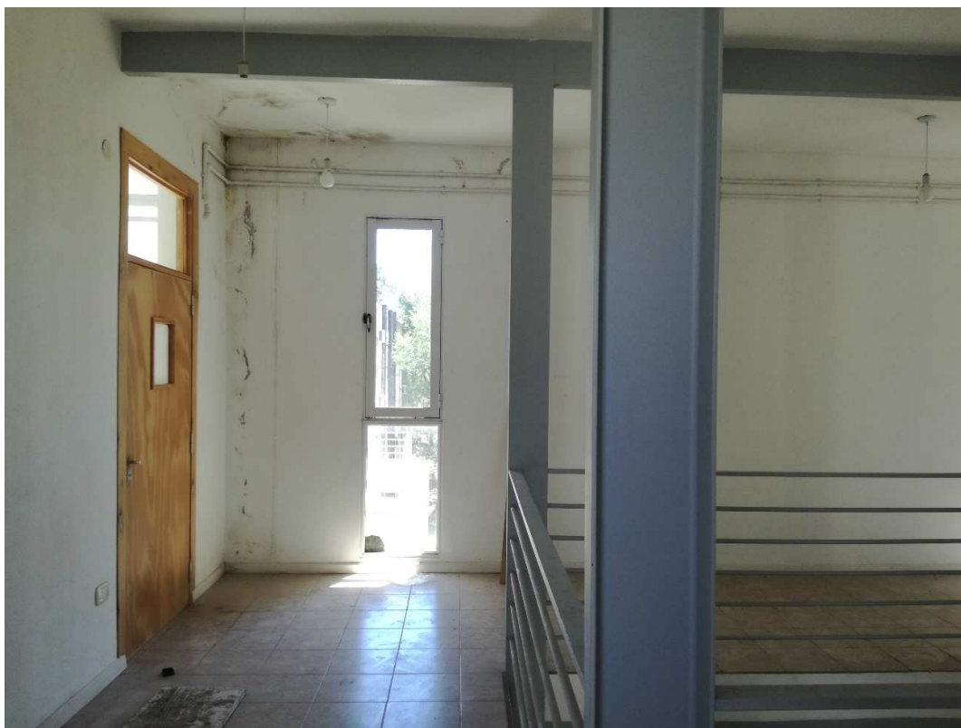
FOTO 12 y 13: Hongos y rastros de filtraciones perimetrales; desprendimiento del revoque en esquina donde desagua el pluvial
